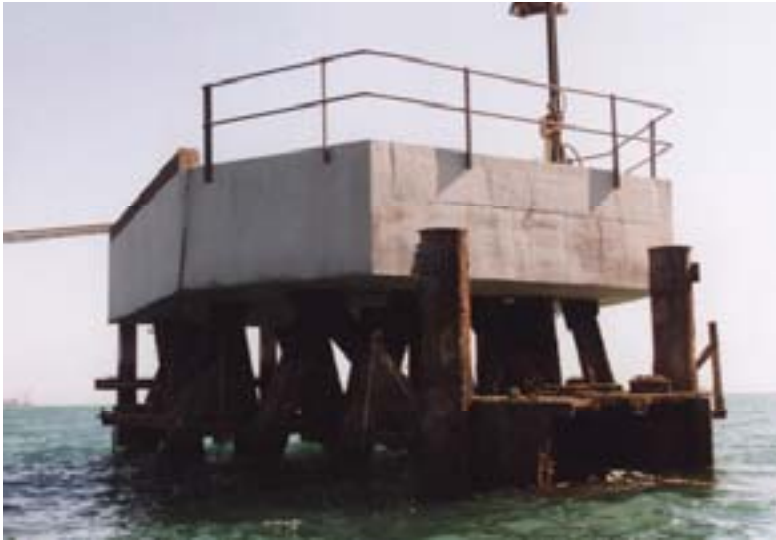
Bild 8: Betonstruktur im Arabischen Golf 1,5 Jahre nach Installation des CP-Systems (1999)
